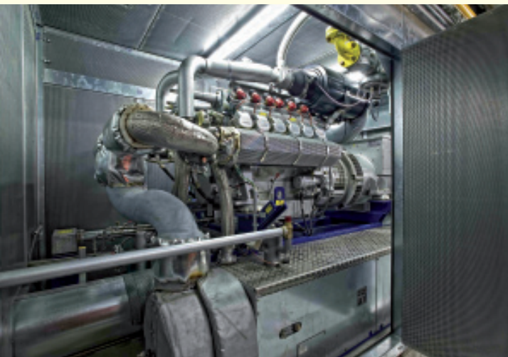
Blockheizkraftwerk des Landeskriminalamts Baden-Württemberg in seiner Einhausung
