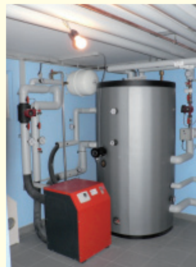
Wärmepumpe und Warmwasserspeicher für ein Wohnhaus
