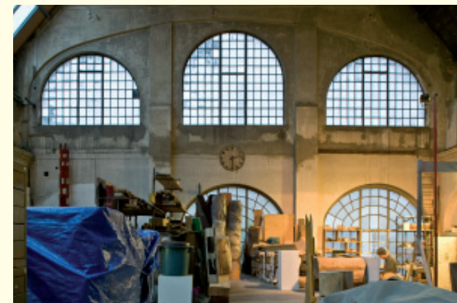
Die Maschinenhalle mit ihrer bauzeitlichen Shedverglasung wird unter anderem als Künstleratelier genutzt.
