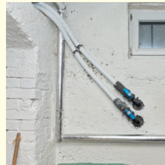
Erdsondenrohre im Kellergeschoss
